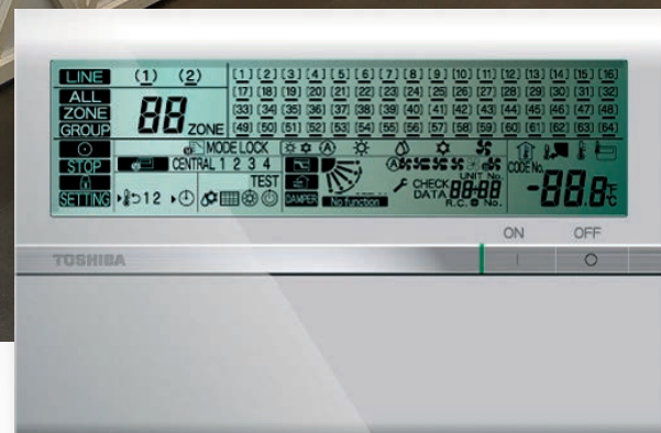
Smart Manager – zentrale Regelung mit Funktionen zur Energieüberwachung und Berichterstellung
